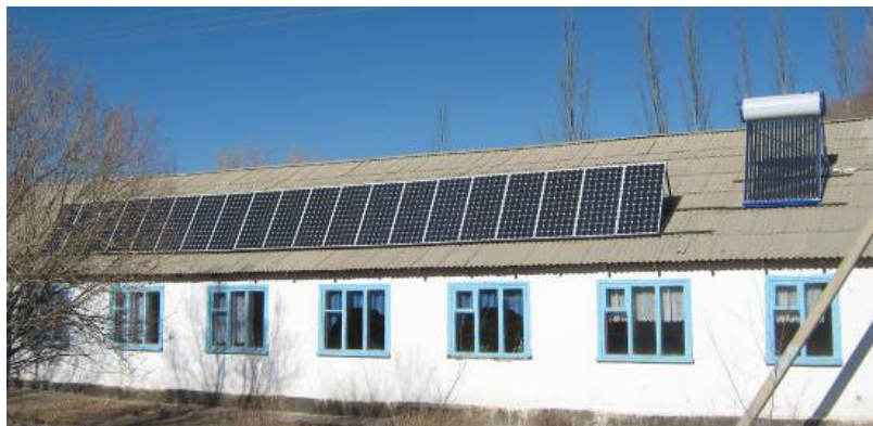
Рис. 26. Вакуумная солнечная водонагревательная установка на 100 л. (справа) для ГВС столовой. Фотоэлектрическая станция мощностью 2 кВт (слева) для электроснабжения здания школы; площадь фотомодулей 12 м 2 .
